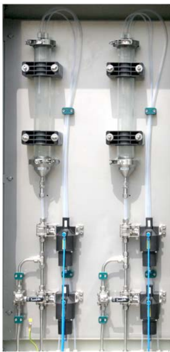
现场在用的样品前处理系统
