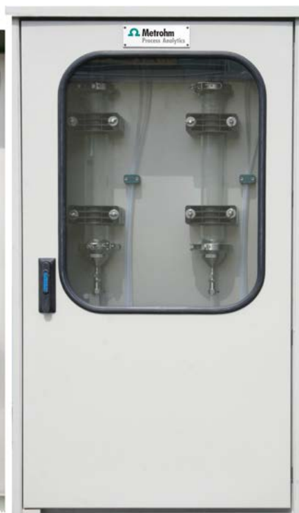
现场在用的样品前处理系统与分析小屋
